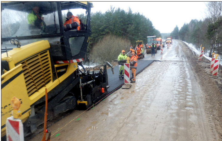
Ant valstybinės reikšmės krašto kelio Nr. 118 Kupiškis–Utena ties Alaušo ežeru paklota nauja asfalto danga
